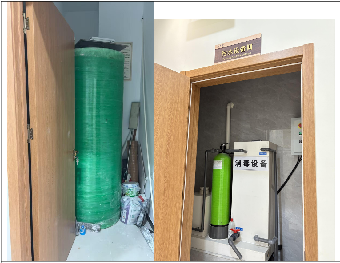
图 3-3 一体化污水处理设备+消毒设备
